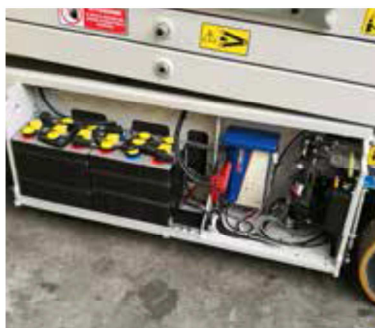
Prostor pro akumulátory
