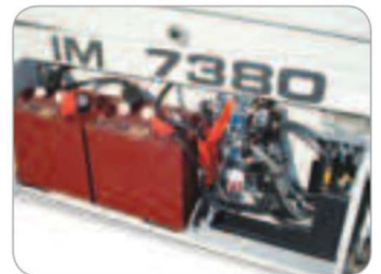
Prostor pro akumulátory
